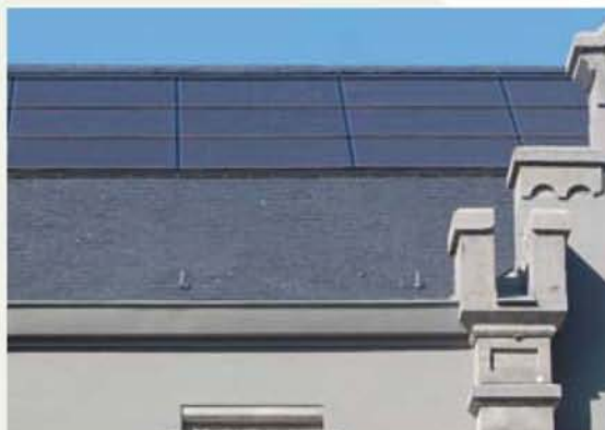
Les panneaux photovoltaïques placés en toiture.
