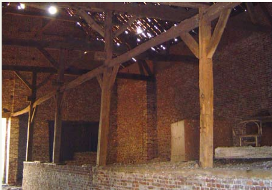
La grange avant travaux : le muret de soutien des poteaux divise la grange en deux.
