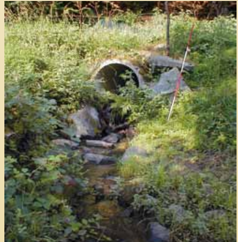
Chute aval générée par le passage busé du ruisseau de la Saint-Nicolas (90) avant son aménagement.
