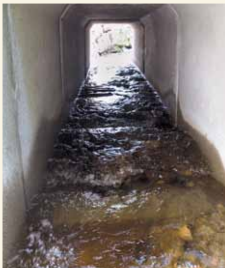
Vue amont du dalot du ruisseau d'Avau montrant les "barrettes" de fixation de sédiment.
